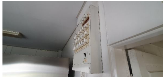
Keittiön sulakekaappi, eristelevy sisältää asbestia
