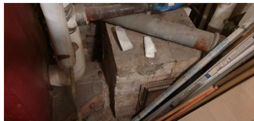
kattilahuoneen savusola, sisältää asbestia
