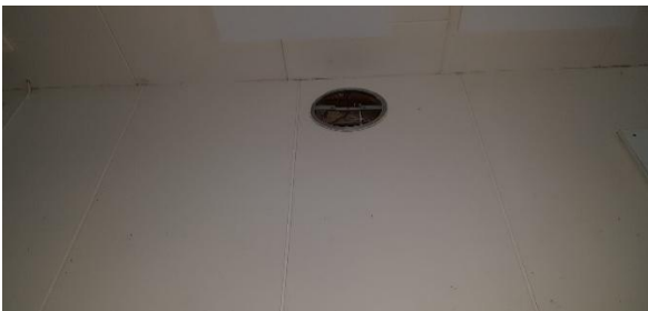
liikuntasalin iv-kanava, ei havaittu asbestia
