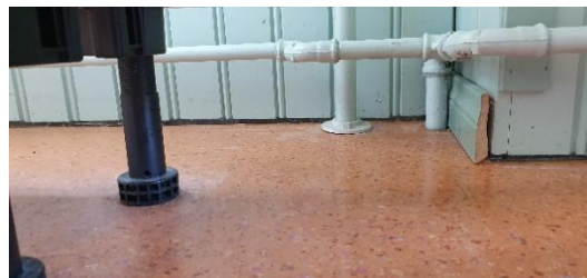
luokka 121, lattian alla putkieristeissä asbestia
