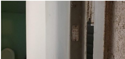
kattilahuoneen palo-ovi, sisältää asbestia
