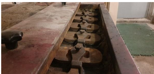
Kattilan tiivisteet, sisältävät asbestia
