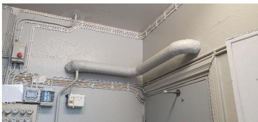
Alakerran käytävän putkieristeet, sisältävät asbestia
