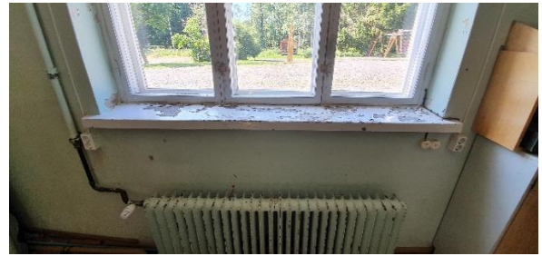
kellarin ikkunapenkki, ei havaittu asbestia (näyte 5)
