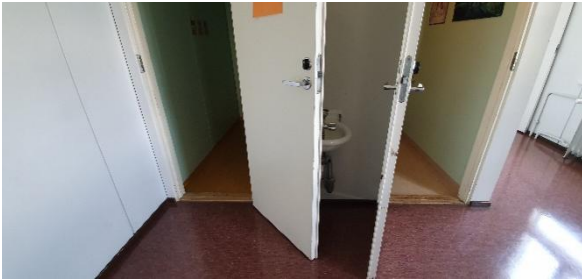
eteisen wc:t 106 ja 107, ei havaittu asbestia
