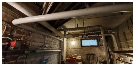
kattilahuoneen putkieristeet, sisältävät asbestia
