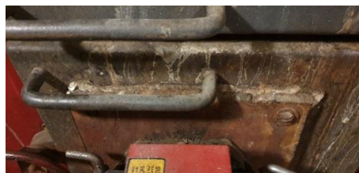
Kattilan kannen tiivisteet, sisältävät asbestia
