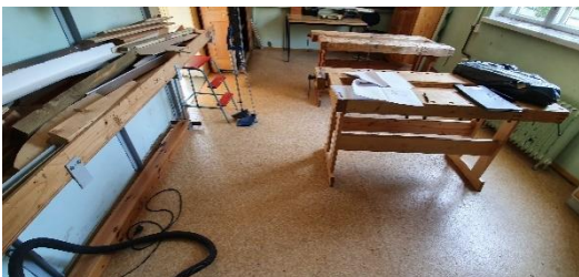
Alakerran puutyöluokan matto, sisältää asbestia (näyte 3)
