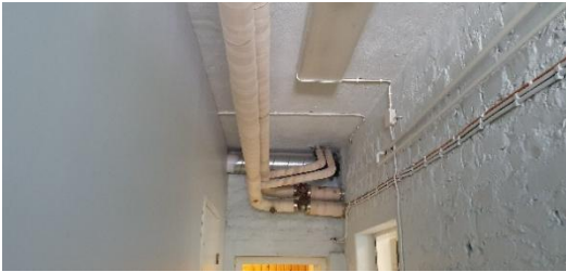
Alakerran käytävän putkieristeet, sisältävät asbestia
