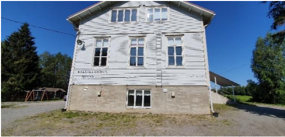
julkisivumaali, ei sisällä asbestia (näyte 1)
