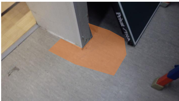
Kuva 92. Poikkeavaa kosteutta havaittiin pintamittarilla mitattuna pienialaisesti tilassa C110.
