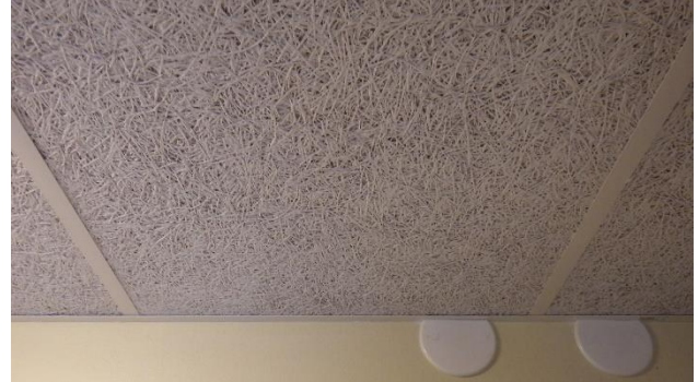
Kuva 99. Toisen kerroksen luokkatilojen alakattolevyt osittain tojalevyä.
