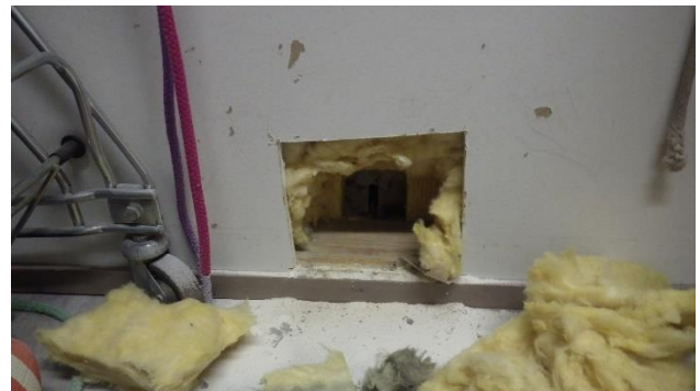
Kuva 32. US-RT6, lämmöneristeessä todettiin epäily mikrobikasvusta materiaalissa. Rakenneavauksessa ei aistittavissa poikkeavaa hajua.
