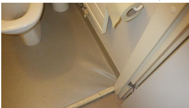
Kuva 96. WC-tilan C120 muovimatto irti alustastaan. Tilassa tunkkainen haju.
