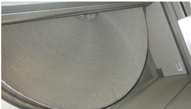
Kuva 78. Pyörivän LTO-kiekon toiminnassa ei puutteita.
