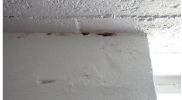
Kuva 23. Tiilimuurauksen liittymät silmin nähden epätiivit, kellarin tiloissa pikisivellystä johtuva ratapölkkymainen haju.
