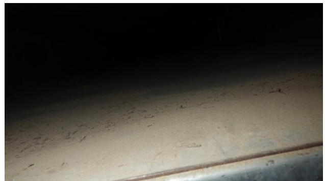
Kuva 71. Aulatilán C101 kohdalla tuloilmakanavan pohjalla runsaasti likaa ja siitepölyä.
