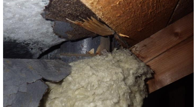
Kuva 65. Epätiivis läpivienti vesikatonle, peltikaton sisäpinta jäätynyt.
