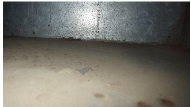
Kuva 69. Tuloilmakanava likainen aulatilán C101 ja liikuntasalin C103 välillä.
