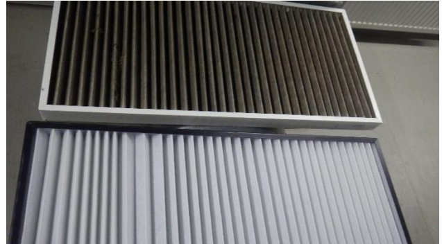
Kuva 86. Tuloilmasuodatin likainen. Alapuolella kuva uudesta suodattimesta.
