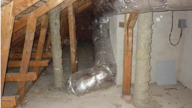
Kuva 64. Yläpohjassa osa iv-kanavista lämmön- ja kondenssisuojattu. Osin kondenssieristykset puuttuvat.
