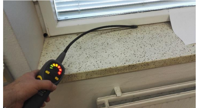
Kuva 103. MA2, tila B206 ulkoseinä. Epätiiveyksiä ikkunapenkin liittymissä.
