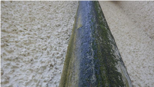
Kuva 11. Tulvineesta sadevesikourusta johtuen syöksytorven ulkopinnalle muodostunut sammalkasvustoa.
