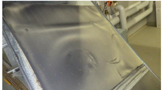
Kuva 88. Selkeistä ohivuodoista johtuen suodattimen ohi kulkeutuu runsaasti siitepölyä ym. epäpuhtauksia.
