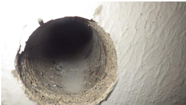
Kuva 21. Rakenteessa ei havaittavissa pikisivelyä.
