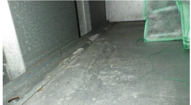
Kuva 77. Lieviä kosteusjälkiä suodattimien jälkeen.
