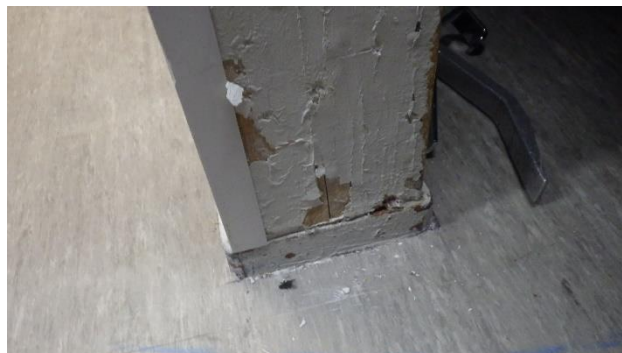
Kuva 93. Vanhoja kosteuden aiheuttamia jälkiä liikuntavarastossa C110. Vettä vuotanut todennäköisesti vesikatolta.
