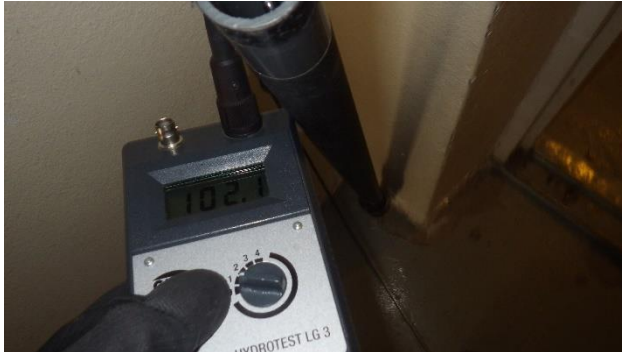
Kuva 42. Poikkeavaa pintakosteutta todettiin pienialaisesti tilassa C110. (mittarin lukema 102,1)
