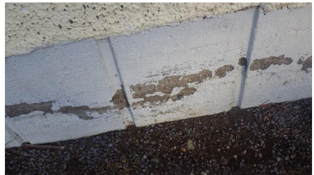
Kuva 18. Sokkelit huoltomaalauksen tarpeessa.
