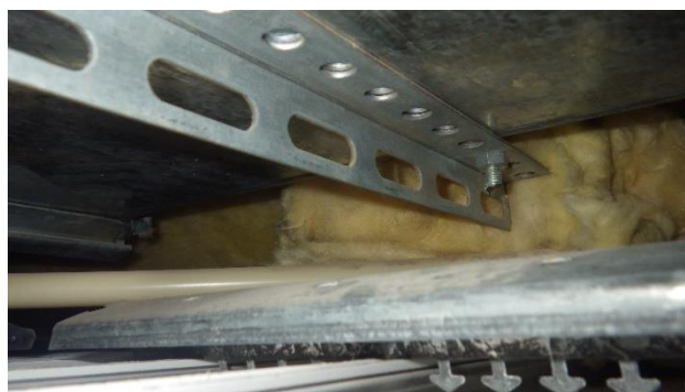
Kuva 95. Alakattotilassa todettiin avoimia mineraalivillapintoja aulatilassa C101.
