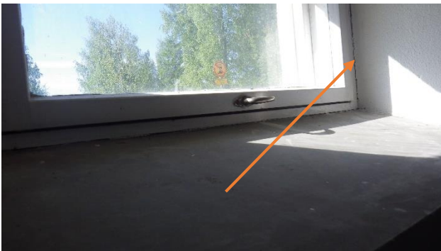
Kuva 24. Ikkunan rakenneliittymät epätiivit.
