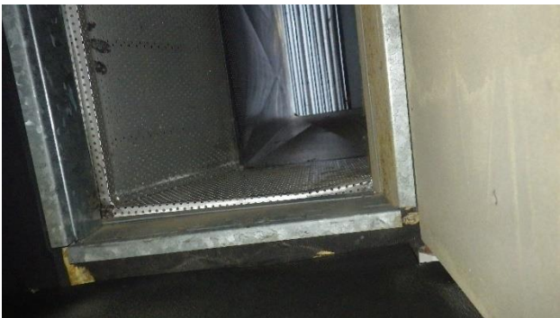
Kuva 84. Ilmanvaihtokoneessa havaittiin reikäpellitettyä mineraalivillaa.
