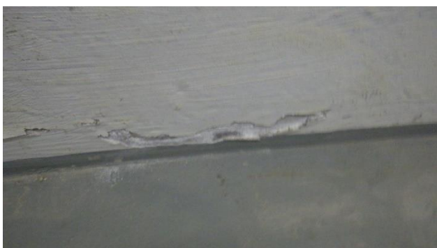
Kuva 94. Kellarissa kantavien väliseinien alaosissa paikoin kosteuden aiheuttamia jälkiä.
