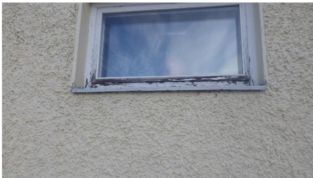
Kuva 17. Alkuperäisten puuikkunoiden kunnossa puutteita.
