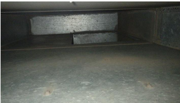
Kuva 68. Tuloilmakanava likainen aulatilán C101 ja liikuntasalin C103 välillä.
