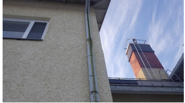
Kuva 10. Syöksytorvet huollon tarpeessa.
