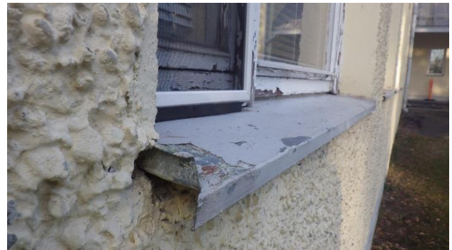
Kuva 20. Ikkunapeltien kaadossa puutteita.
