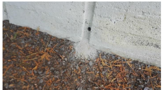
Kuva 34. SOK-RT2, sokkelin halkaisussa todettiin alkuperäisellä osalla rakennusajankohdalle tyypillinen toja-eriste.
