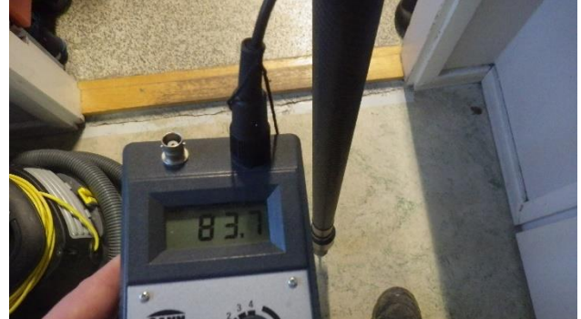
Kuva 37. Tilassa B105 magnesiamaalattia. (Mittarin lukema 83,7)
