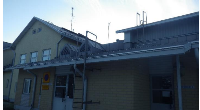
Kuva 53. Vesikaton muotoja liikuntasalin puolella.
