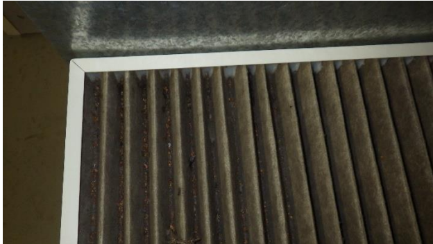
Kuva 85. Tuloilmasuodatin likainen. Suodatin täynnä likaa ja hyönteisiä.
