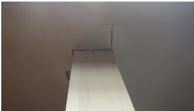
Kuva 54. Liikuntasalin vesikatolta vuotanut vettä varastoon C110.
