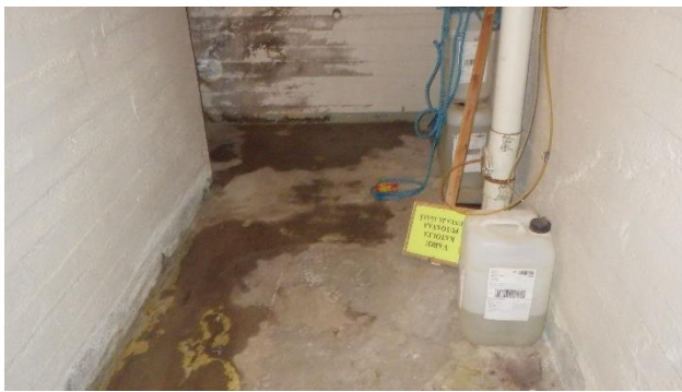
Kuva 17. Porrashuoneessa 001 betonilattia, alapohjassa kosteuden aiheuttamia jälkiä.
