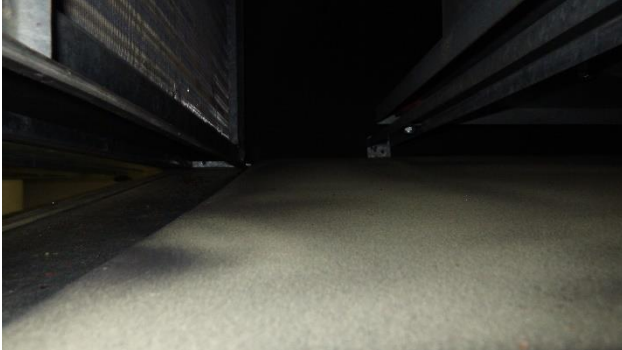
Kuva 80. Tarkastusluukun pohjalla runsaasti siitepölyä ym. ulkoilmapölyä.
