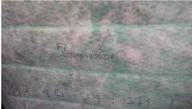
Kuva 76. Tuloilmasuodattimet luokkaa F7, TK-03.
