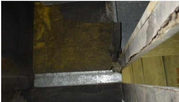
Kuva 87. Avointa villapintaa tulokoneen raitisilmakammion jälkeen.
