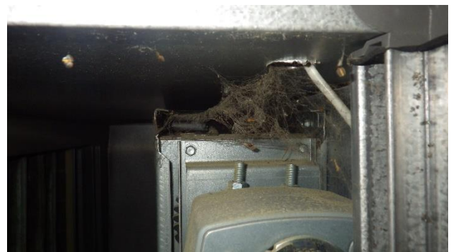
Kuva 75. Tuloilmakoneessa todettiin runsaasti likaa ennen suodattimia.
