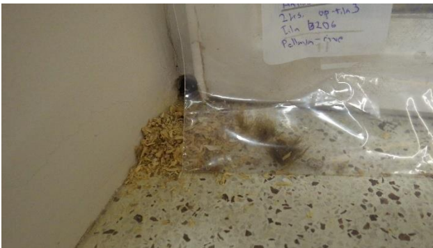
Kuva 31. IKK-RT1, rakenneavauksessa aistittavissa voimakas mikrobiperäinen haju, näytteessä todettiin epäily mikrobikasvusta materiaalissa.
