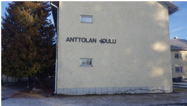
Kuva 5. Sokkelissa havaittavissa maalipinnan irtoilua / halkeilua. Sokkelipinnat huoltomaalauksen tarpeessa.
