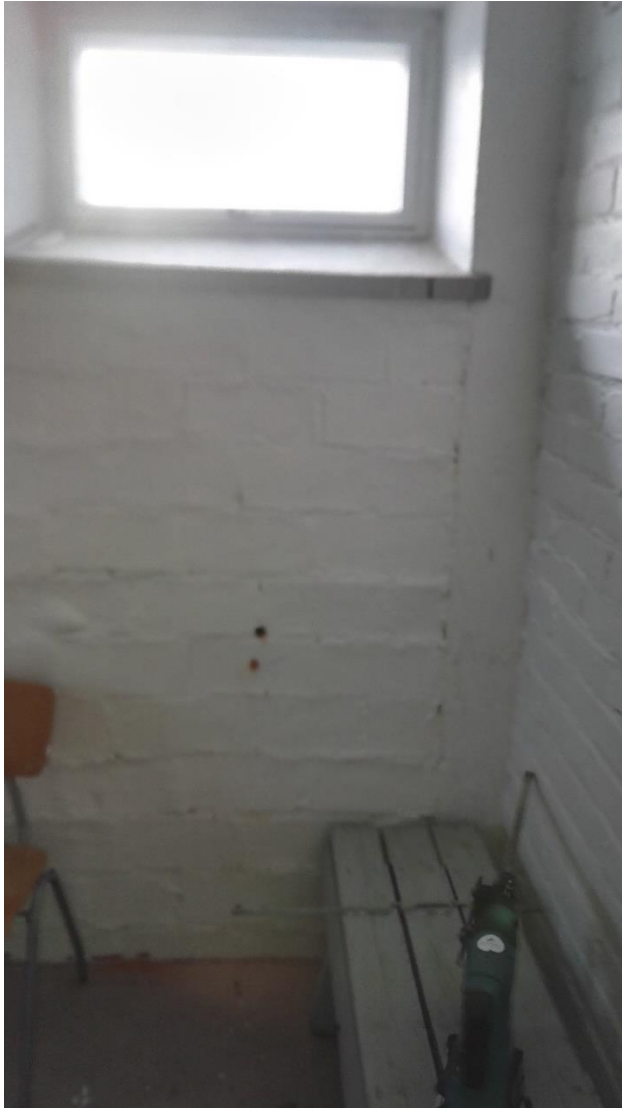
Kuva 35. MVUS-RT1, eristeessä ei todettu poikkeavaa mikrobikasvua. Rakenneavauksessa aistittavissa voimakas pikisivelyn haju.
