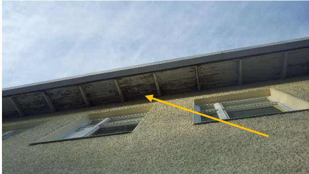
Kuva 52. Alkuperäisen rakennusosan räystäslaudat huollon tarpeessa.
