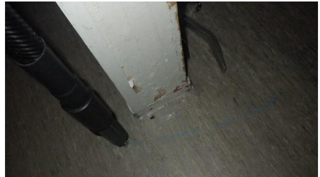
Kuva 39. Poikkeavaa pintakosteutta todettiin pienialaisesti tilassa C110.
