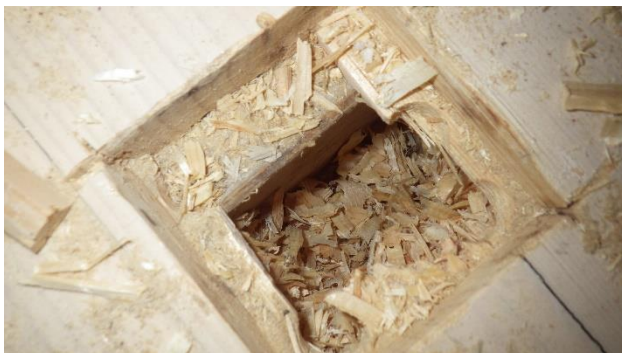
Kuva 48. VP-RT1, purueristeessä ei todettu poikkeavaa mikrobikasvua, avauksessa ei mikrobi-peräistä hajua.
