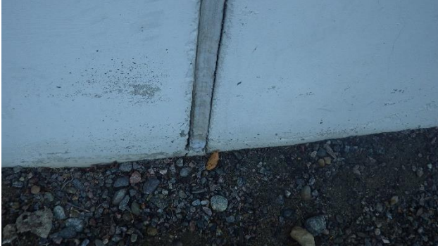
Kuva 29. Liikuntasalin sokkelin elementtisaumoissa epätiiveyksiä.
