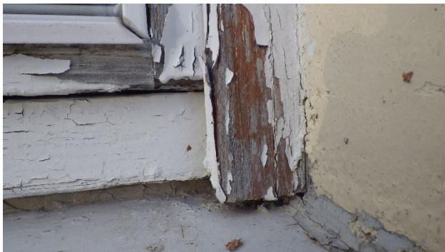
Kuva 21. Alkuperäiset (1957) puuikkunat ovat teknisen käyttöikänsä päässä.
