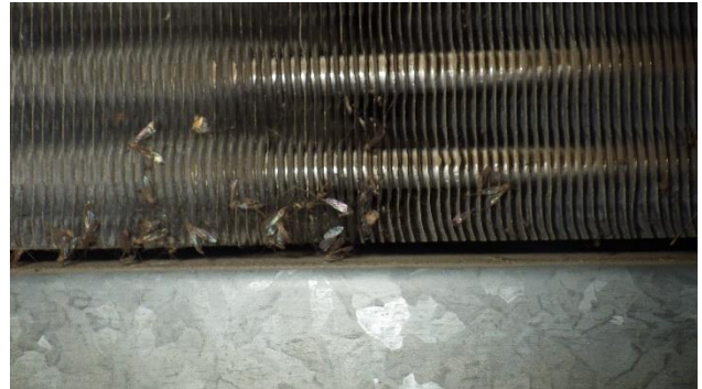
Kuva 83. Jälkilämmityspatterin säleikkö täynnä hyönteisiä.
