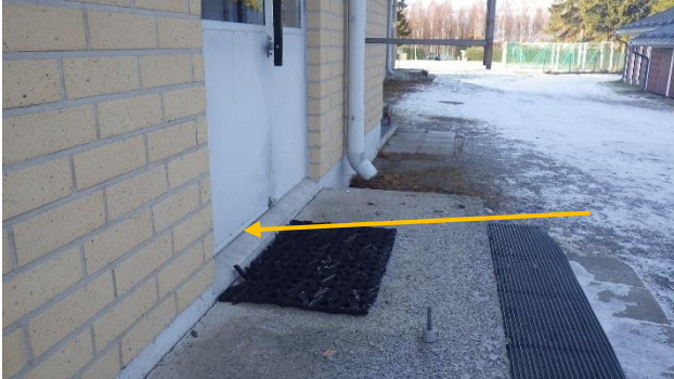
Kuva 36. Alapohjan korkoasema liikuntasalin puolella.
