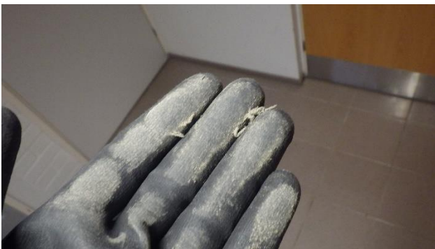
Kuva 70. Aulatilán C101 kohdalla tuloilmakanavan pohjalla runsaasti likaa ja siitepölyä.
