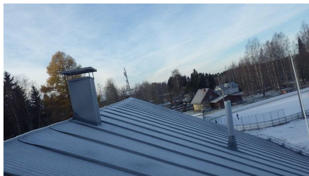
Kuva 61. Viemärin tuuletusputket on tuotu asianmukaisesti vesikatolle, osassa tuuletusputkien läpivientien tiiveyksissä havaittiin puutteita.
