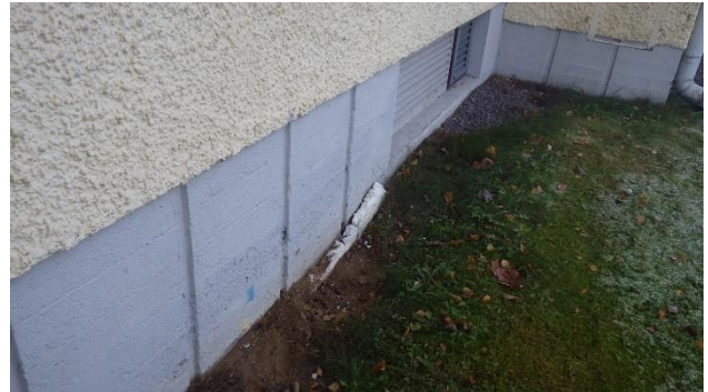
Kuva 12. Osa kellarin ikkunoista / aukoista lähellä maanpintaa.
