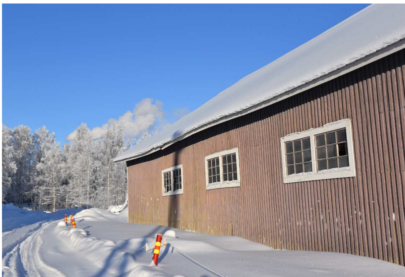
Kuva: Rakennuksen lännenpuoleinen sivuseinä. Perustuksen liikkuminen näkyy katon aaltoiluna.
