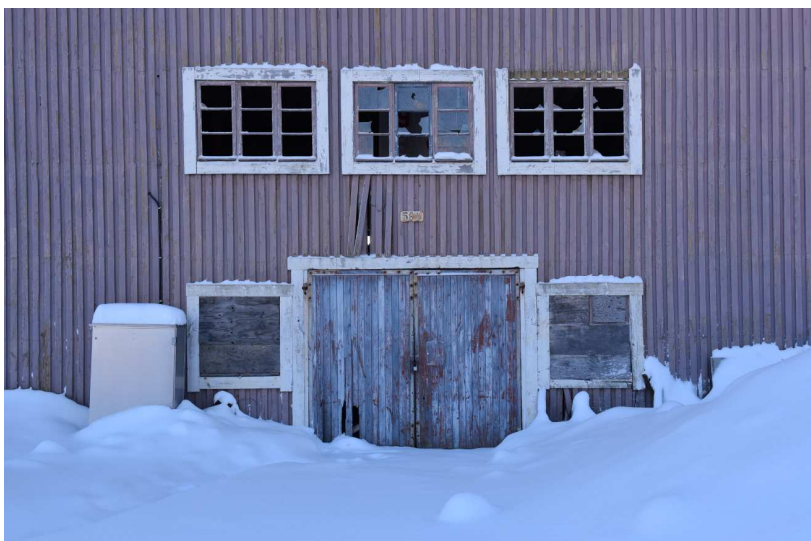
Kuva: Pohjoispääty. Rakennuksen ikkunoita ja ovia on rikki. Vuorilaudoitus on ikääntynyt, erityisen laajalti eteläpäädyssä. Pellille maalattu tunnus 56 L on säilynyt pohjoispäädyn oven yllä.
